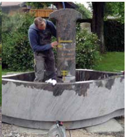
Die beiden Oberteile der Mittelsäule werden präzise aufeinandergesetzt und nach zwei Stunden steht der neue Friedhofsbrunnen.
