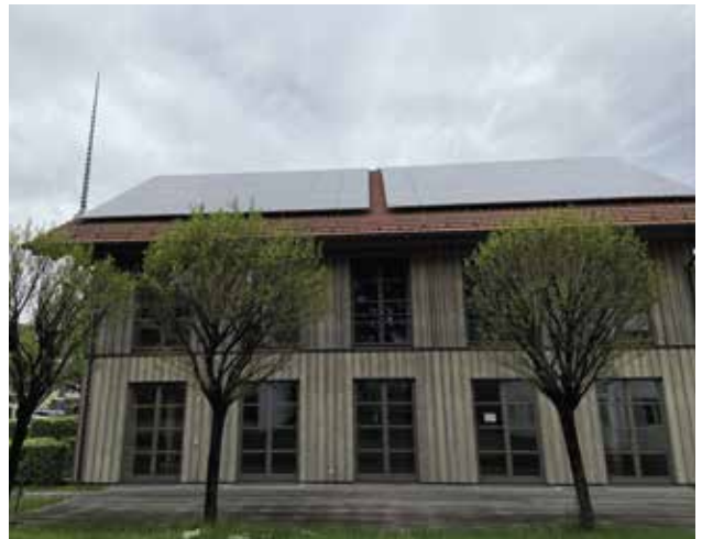
Gemeindeeigene Photovoltaikanlage auf dem Dach des Pfarrzentrums
